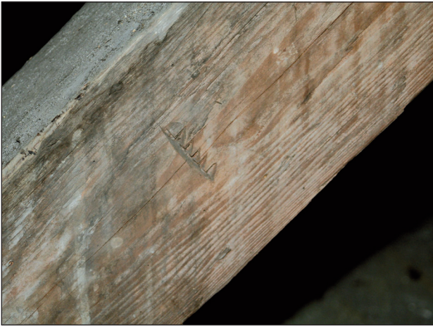
16. Bóżnica w Fordonie, więźba dachowa, ciesielski znak montażowy tzw. pilasty, wiązary piąty, 2008 r.; fot. A. Jankowski 16. The synagogue in Fordon, the rafter framing, the carpenter's mounting sign, so-called sawtooth, fifth roof truss, 2008; photo A. Jankowski
