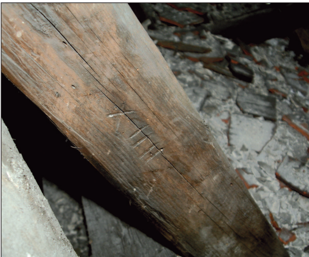
17. Bóżnica w Fordonie, więźba dachowa, ciesielski znak montażowy, cyfra „14”, 2008 r.; fot. A. Jankowski 17. The synagogue in Fordon, the rafter framing, the carpenter's mounting sign, figure “14”, 2008; photo A. Jankowski
