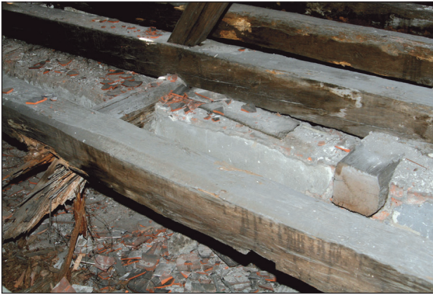
11. Bóżnica w Fordonie, wnętrze, pierwotne podciąganie belek stropowych babińca (jeden uszkodzony, drugi obcięty), 2008 r.; fot. A. Jankowski 11. The synagogue in Fordon, the interior, original binding joists of the women's gallery (damaged and cut out), 2008; photo A. Jankowski
