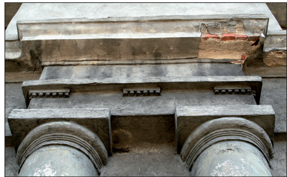
6. Bóżnica w Fordonie, elewacja frontowa, fragment „toskany”, 2008 r.; fot. A. Jankowski 6. The synagogue in Fordon, the front elevation, semicolumns of Tuscan type (details), 2008; photo A. Jankowski
