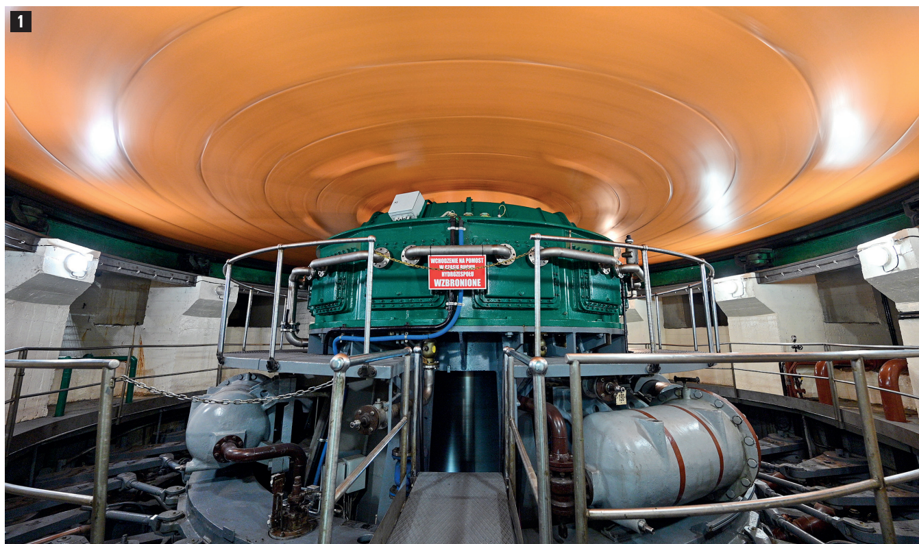
Fot. 1 Pracujący hydrozespół (łożysko nośne, wirnik generatora)
