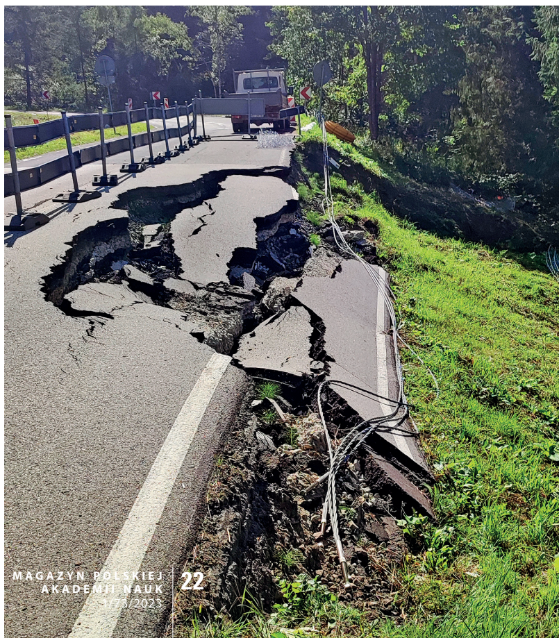
Uszkodzony przez osuwisko fragment drogi między Wetliną a Brzegami Górnymi
